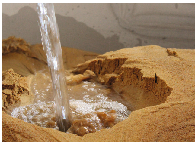
Processus de décalcification dans un site de production d'eau potable
