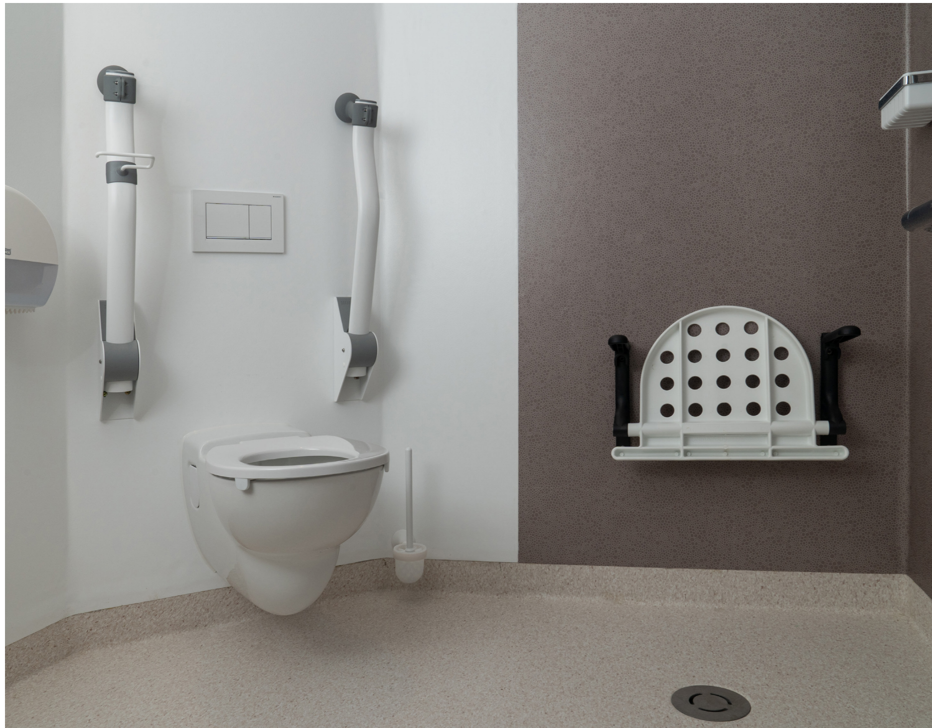
Geïnstalleerde producten: Acczent Excellence 80
